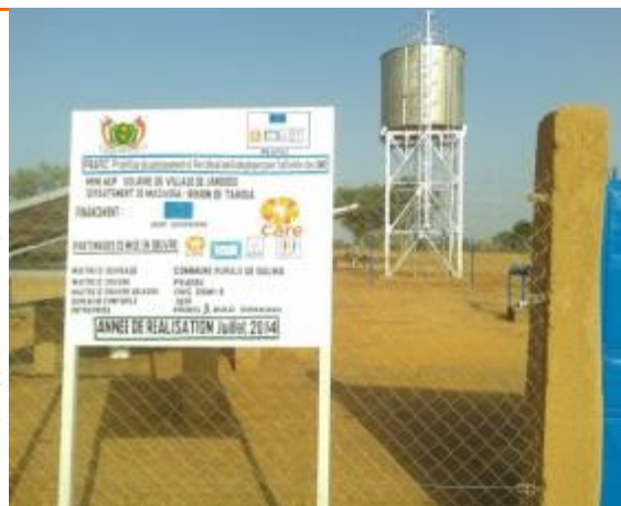
Mini AEP solaire de Arewa Kelkamza dans la commune rurale de Galma
